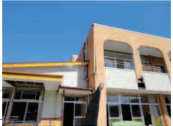
外壁に大きなクラック 建具や雨戸の鏡板変形
