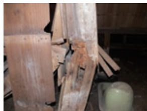
着工前 (柱の腐り)
