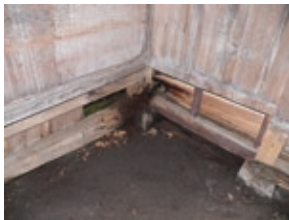
着工前 (土台の腐り)
